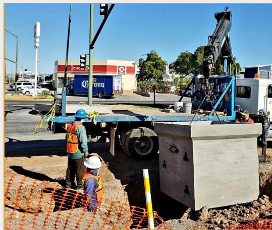
Banco de ductos Hermosillo
