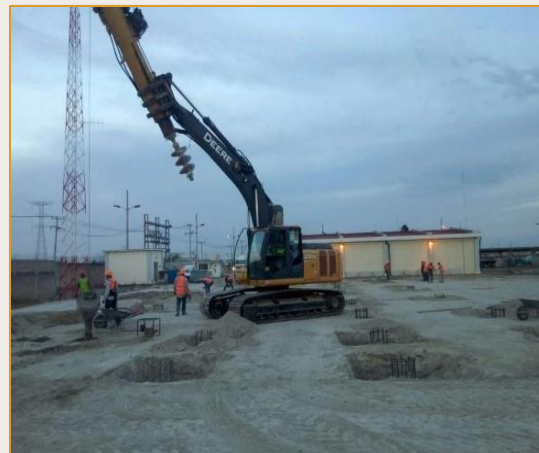
Subestación Tuzanía Zapopan
