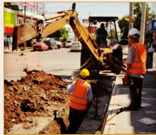
Banco de ductos Los Mochis
